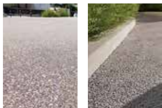
Asphalt mit heller Einstreu oder Saibro wasserdurchlässig
